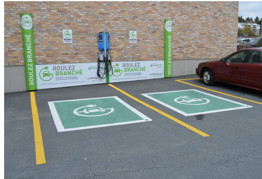
FIGURE 35: BORNES DE RECHARGE ÉLECTRIQUES AU SEIN D'UNE AIRE DE STATIONNEMENT PRIVÉE (CRÉDIT PHOTO : L'ÉCLAIREUR PROGRÈS)
